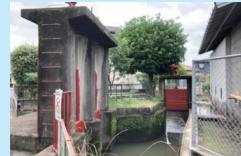
▲山添堤、内畑堤、雨水幹線への水の流れを調整する寺福童堰
