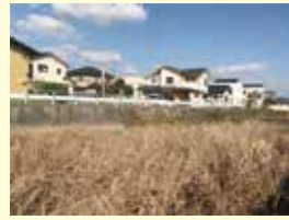
7月の豪雨で道路路面が崩壊した寺福童内畑堤、今年度中に道路災害復旧工事が施工されます。
