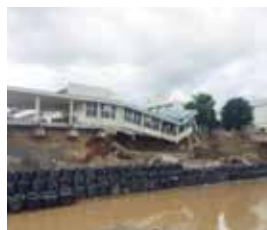
大きく崩壊した比良松中学校
